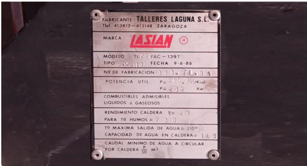
Características caldera existente
