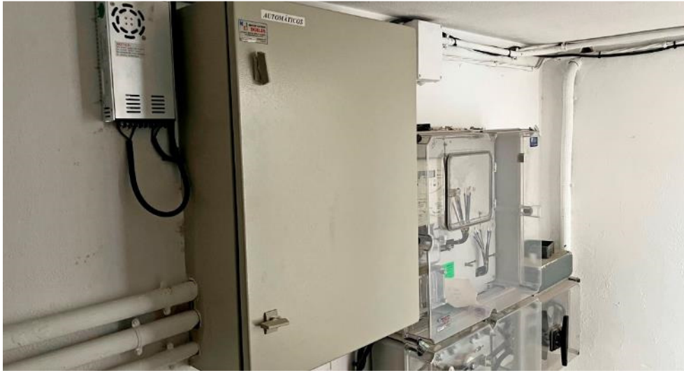
Interior planta baja, cuarto de instalaciones bajo escalera
