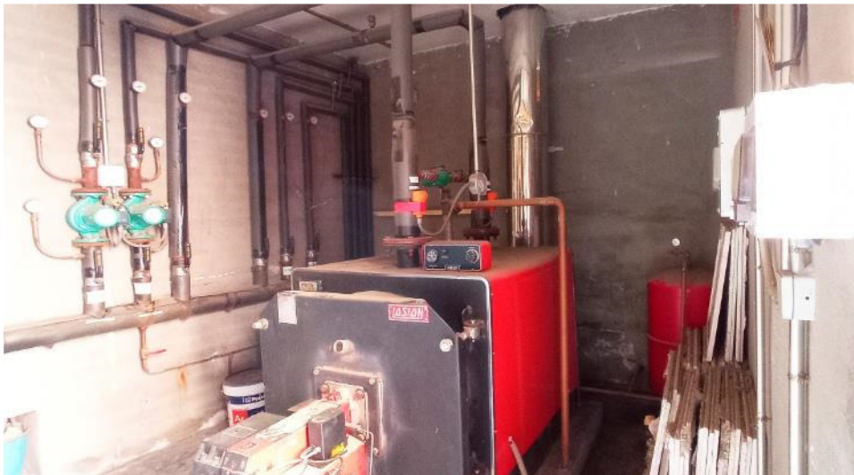
Interior planta baja, cuarto de instalaciones caldera
