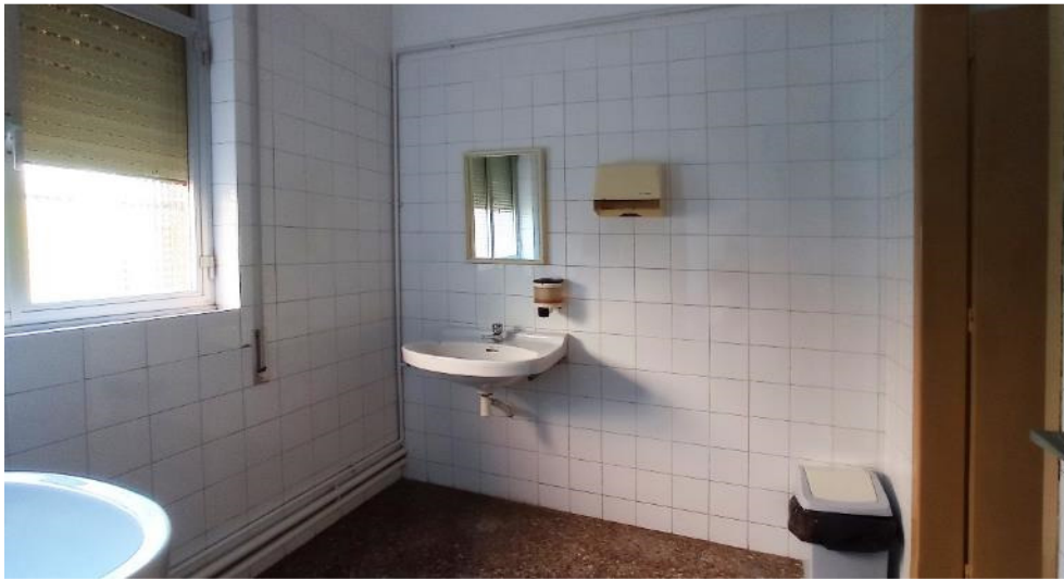
Interior planta baja, aseos
