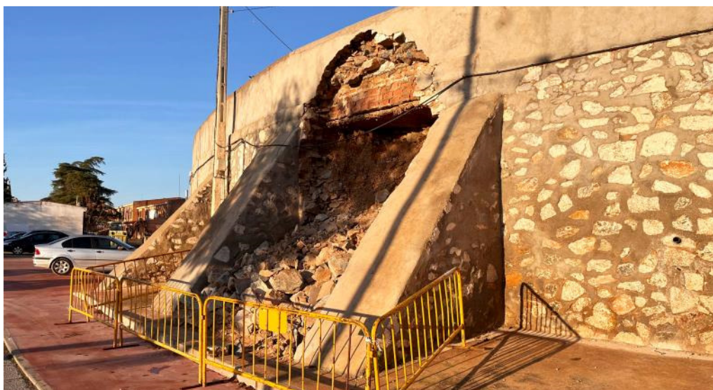
Tramo de cerramiento dañado lienzo sureste – colapso fábrica de mampostería
