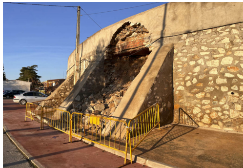
Vista general derrumbe entre contrafuertes 5 y 6 (cerramiento sureste)
