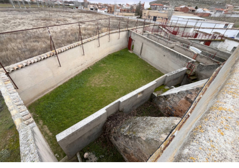
Vista general corrales ganadería y pasarelas a toriles
