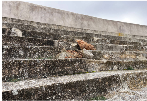
Irregularidades firme de gradas, impidiendo correcta evacuación agua
