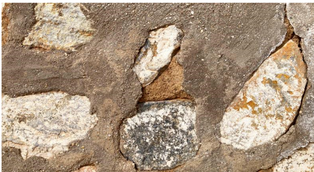
Elevada presencia de mortero de cemento enmascarando morteros de junta originales
