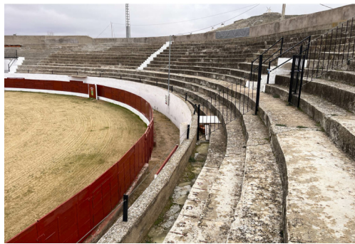
Vista general graderío sureste, elevada presencia de humedad
