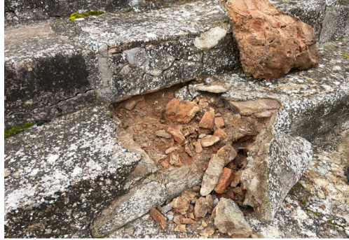
Escalón de grada dañado, vista interior de su composición
