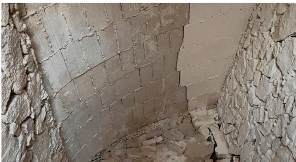
Grietas en bóvedas de taquillas
