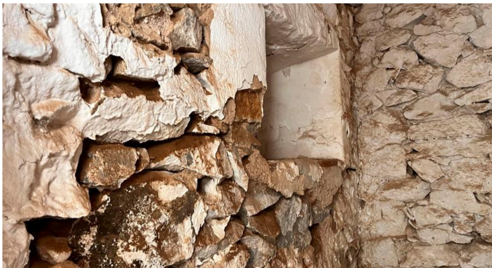
Ausencia de mortero en junta en fábricas de cerramiento de taquillas
