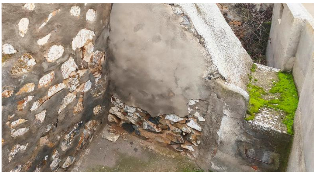
Revestimiento de paños con mortero de cemento, impidiendo la transpirabilidad de los elementos
