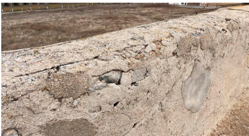
Fábrica de mampostería peto superior – desprendimientos mortero
